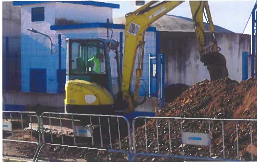
Figura 2. - Empreitada de Substituição da conduta de abastecimento público de água as aldeias da Nossa Senhora das Neves, Vila Azedo e Porto Peles
